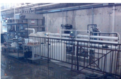
Sistema de Ultrafiltración
